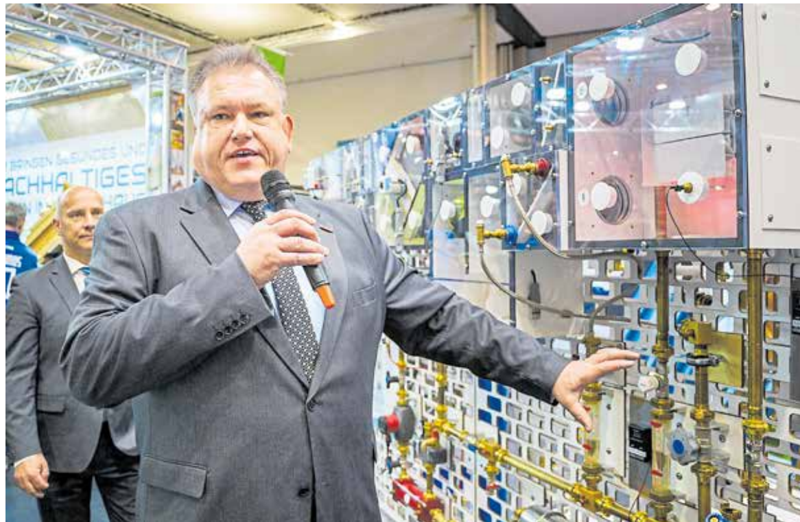
Handwerkskammer-Hauptgeschäftsführer Andreas Brzezinski machte beim Messerundgang auf die Lehranlage zum hydraulischen Abgleich von Heizungsanlagen der Handwerkskammer Dresden aufmerksam. Foto: André Wirsig
