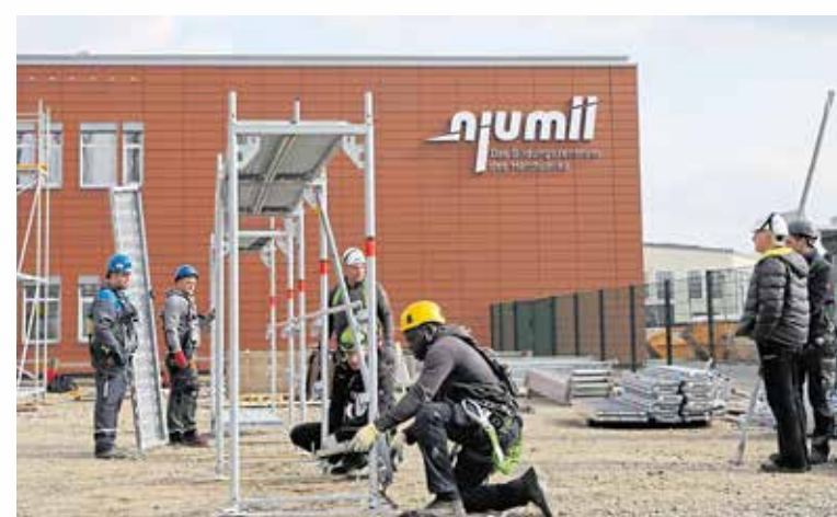
Künftig werden in Kooperation mit der SOKA Gerüstbau Geprüfte Gerüstbau-Montageleiter in njumii ausgebildet. Foto: Handwerkskammer Dresden
